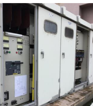
キュービクル扉破損 (暴風)
