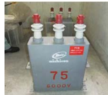
電力用コンデンサー
