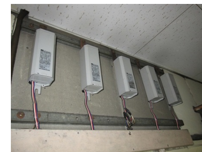
工場等の壁際に設置されている例
