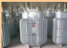
高圧トランス
