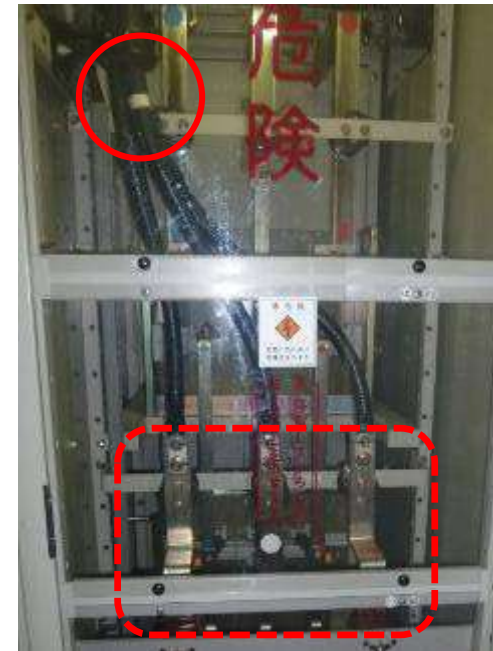
充電部露出箇所
