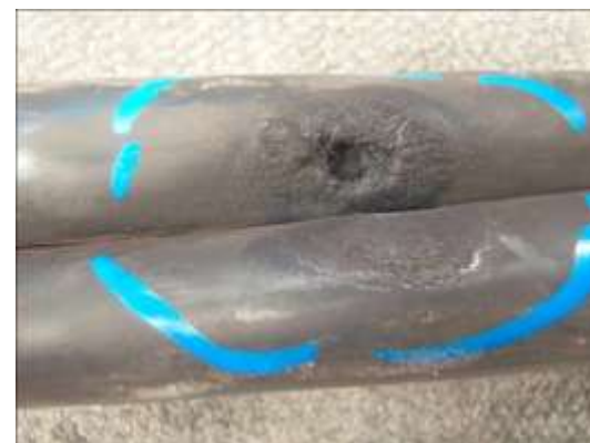
水トリ-による絶縁破壊事例
