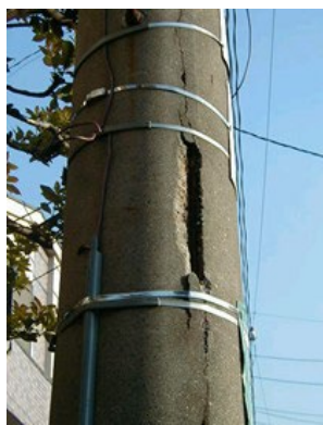
合わせ目の劣化
