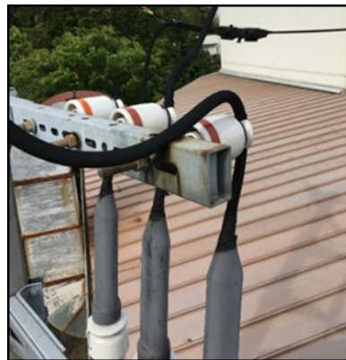
保守不完全事例 (リード線と腕金が接触し、地絡)
