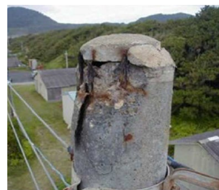
塩害による頂部の剥離
