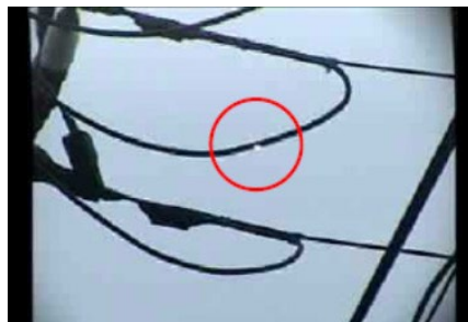
開閉器リード線の放電
