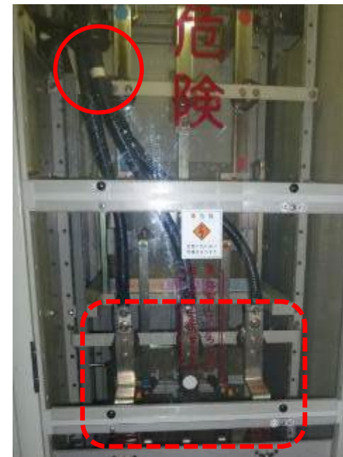
充電部露出箇所
