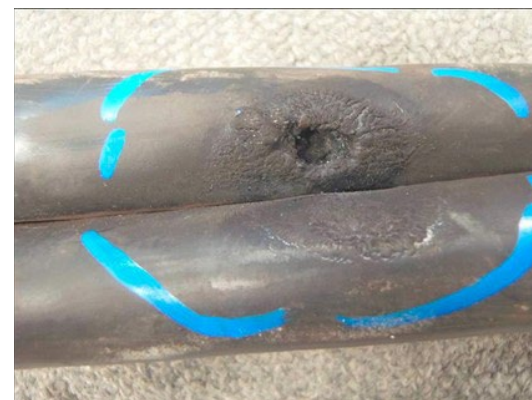
水トリ-による絶縁破壊事例
