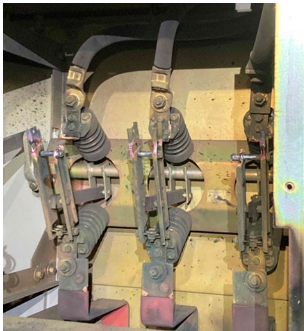
破損した断路器
