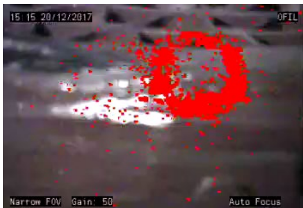
故障モールド変圧器の部分放電
