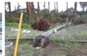
構内柱倒壊 (暴風・倒木)
